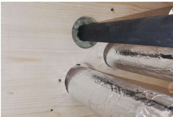
Abb. 19: Ringspalt (Abstand zwischen Brettsperrholz und Rohr) von \leq 10\text{ mm} – ausgestopft mit Mineralwolle (Schmelzpunkt \geq 1000\text{ °C} )
