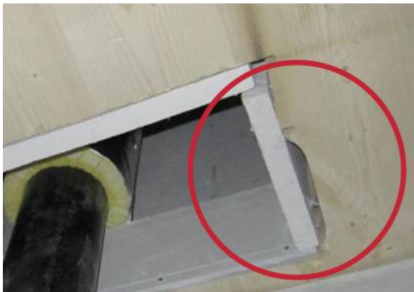
Abb. 32: Praxisfehler – Zuschnitt auf der Baustelle, GKF liegt nicht vollflächig am Holz auf
