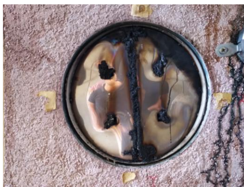
nach Ende der Prüfung (geschlossene Brandschutzklappe)
