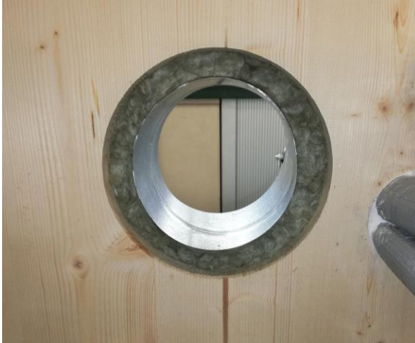
Abb. 24: Ringspalt (Abstand zwischen Brettsperrholz und Rohr) von \leq 30 mm – ausgestopft mit Mineralwolle (Schmelzpunkt \geq 1000 °C)
