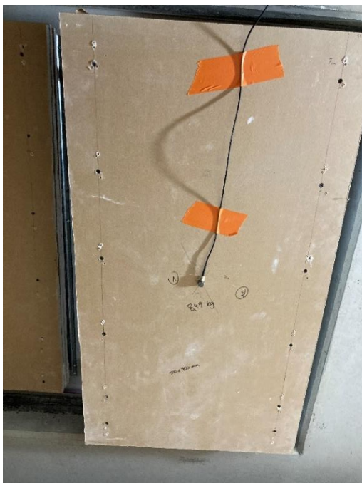
Abbildung 7: Angebrachter Beschleunigungssensor auf der Empfängerseite (Unterdecke)
