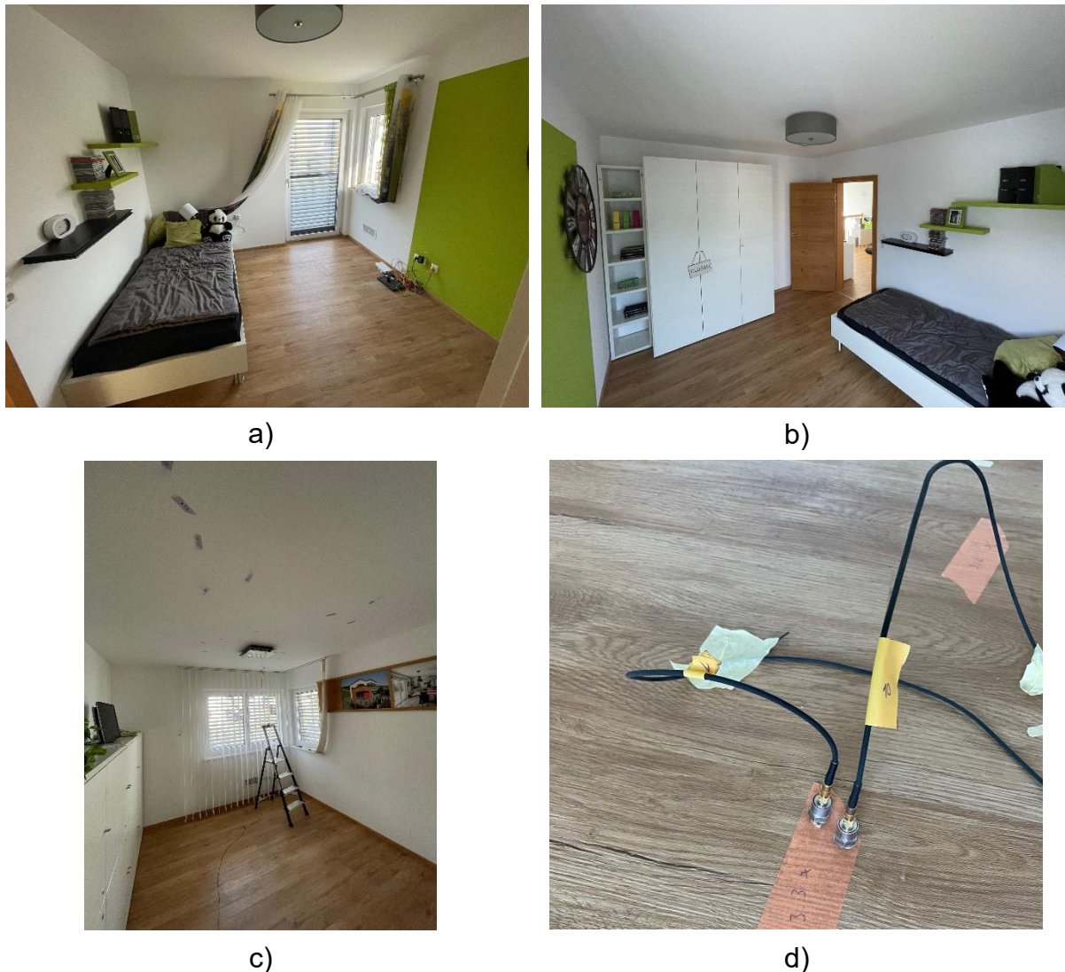
Abbildung 31: a) + b) Senderaum im 1. Stock c) Empfangsraum mit Beschleunigungsaufnehmern an der Decke d) Beschleunigungsaufnehmer am Anregungspunkt
