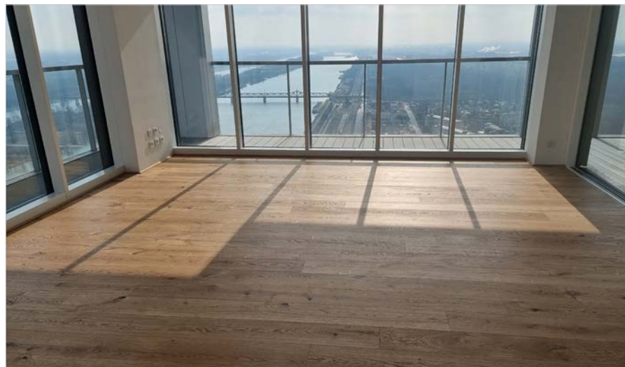
Eine Einwirkung von hohen Temperaturen aufgrund geringer Beschattung und die Estrichfeuchte bei der Verlegung haben Einfluss auf den Parkettboden.
